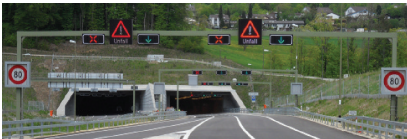
Modernste Verkehrsmanagementsysteme am Eingang zum Uetlibergtunnel
